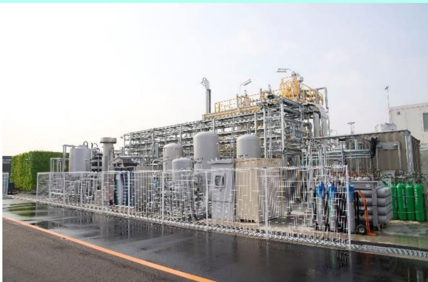
大阪ガス(株)向け メタネーション装置・水電解装置
