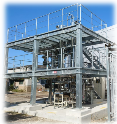
12.5Nm 3 /hメタネーション実証機 (現在: 当社築港工場)
